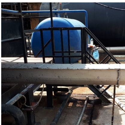
Slika 7. Bojler za proizvodnju pare u okviru mobilnog postrojenja
