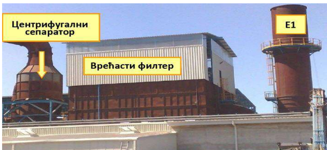
Слика 6.3.5. – Постојење за пречишћавање отпадних гасова електролучне пећи, лончасте пећи и транспорта феролегура
