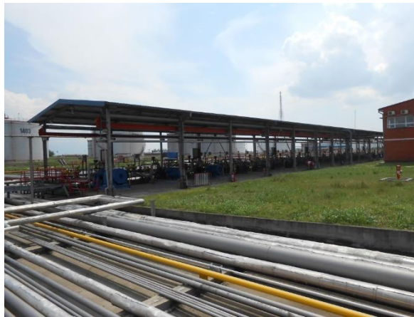
Slika 18. Pumpna stanica u bloku 11
