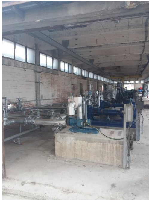
Slika 17. Pumpna stanica u bloku 8
